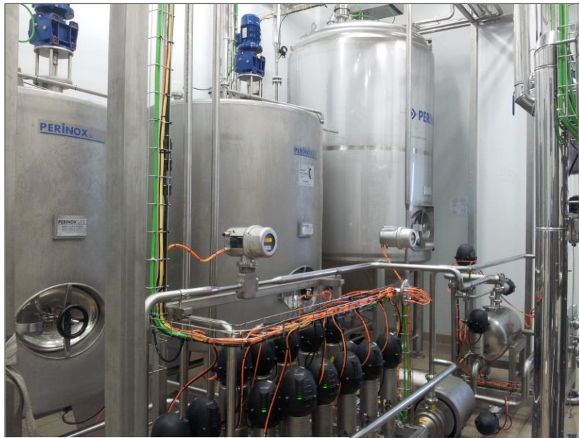
Depósitos isotérmicos de almacenamiento
