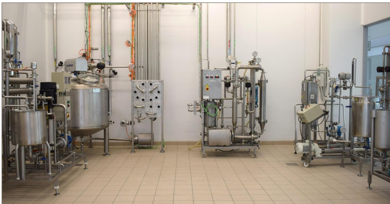
Sala de filtración tangencial
